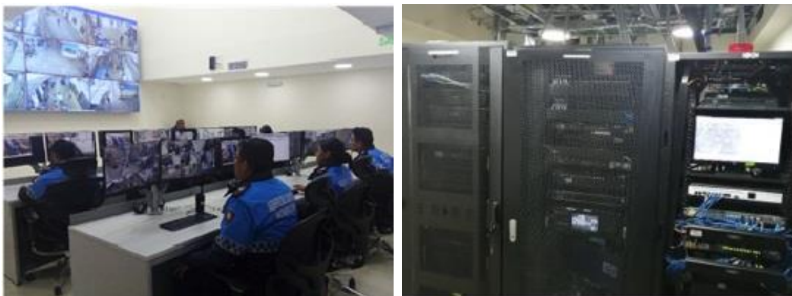
Equipos de monitoreo y gestión de los Sistemas de Video Vigilancia
